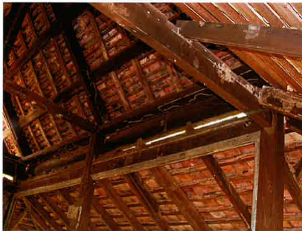
Foto 2: Serangan anai-anai pada kerangka bumbung Sumber: Projek Baikpulih Rumah Penghulu Natar, Merlimau, Melaka, 2009
