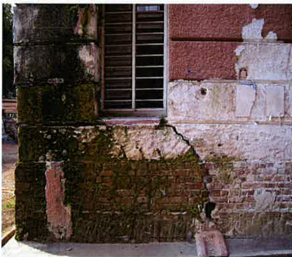
Foto 6: Tumbuhan lumut yang tumbuh pada permukaan dinding Sumber : Projek Pemuliharaan HSBC, Melaka, 2009
