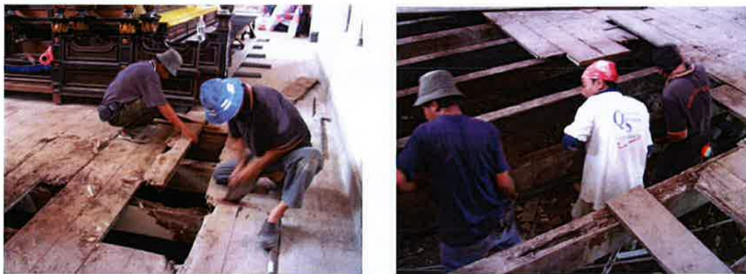
Foto 12: Kecacatan utama pada lantai adalah pereputan kayu akibat serangan anai-anai. Gambar kiri dan kanan; kerja-kerja mengeluarkan papan lantai dan gelegar lantai yang rosak Sumber: Projek Pemuliharaan Muzium Perak, Taiping, 2008
