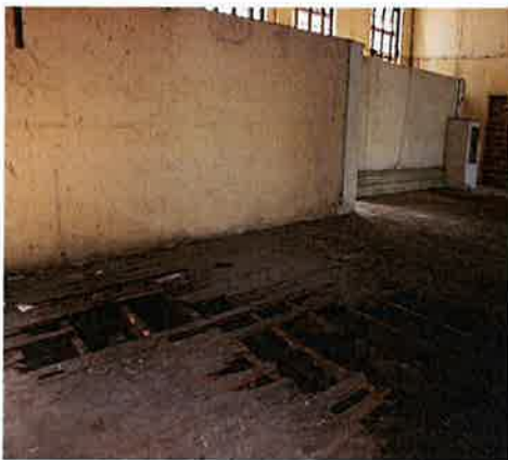
Foto 11: Kerosakan kayu akibat dimakan anai-anai dan mereput Sumber: Projek Kerja-Kerja Konservasi Pejabat Pos Lama, Ipoh, Perak, 2009
